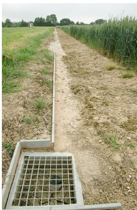
Piège à ruissellement sur le dispositif PCQE
